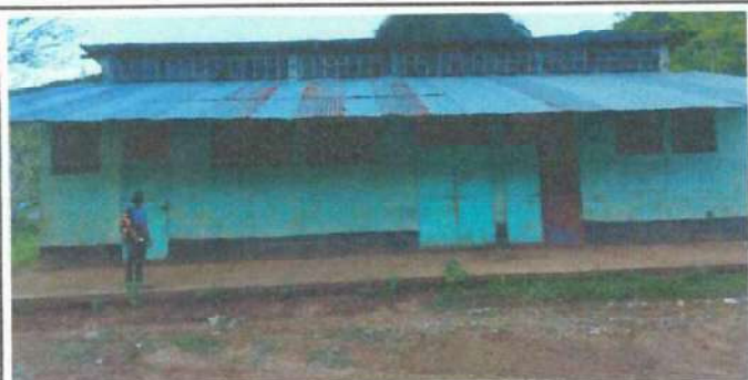
Foto 3: Pared exterior con deterioro por falta de mantenimiento.
