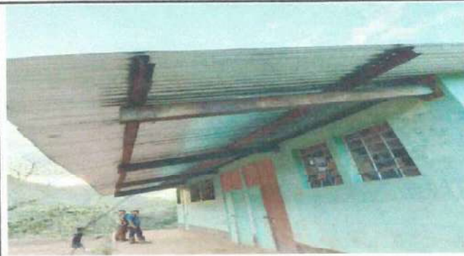
Foto 2: Vista corredor del establecimiento, ventanas con vidrios quebrados.
