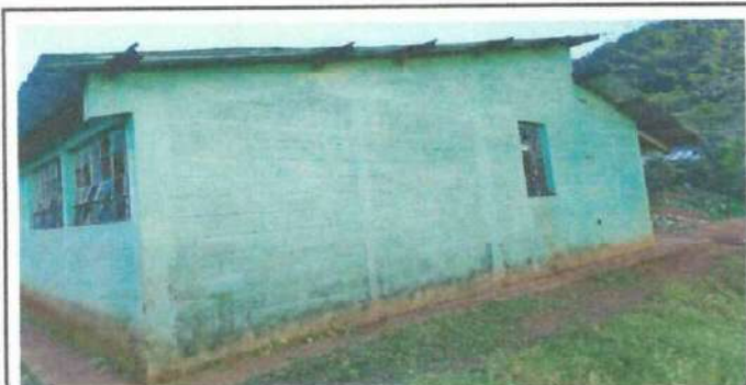
Foto 5: Pintura deteriorada por humedad.
