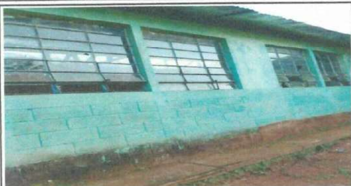
Foto 1: Vista posterior de aula, vidrios quebrados.
