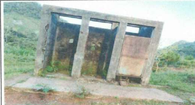
Foto 4: Sanitarios con daños por lluvia.
